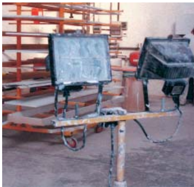
Vista parcial de un foco, con el cristal reflector sucio
