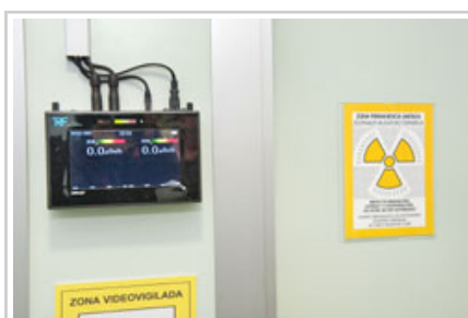
Control de radiactividad en el acceso a las habitaciones.
