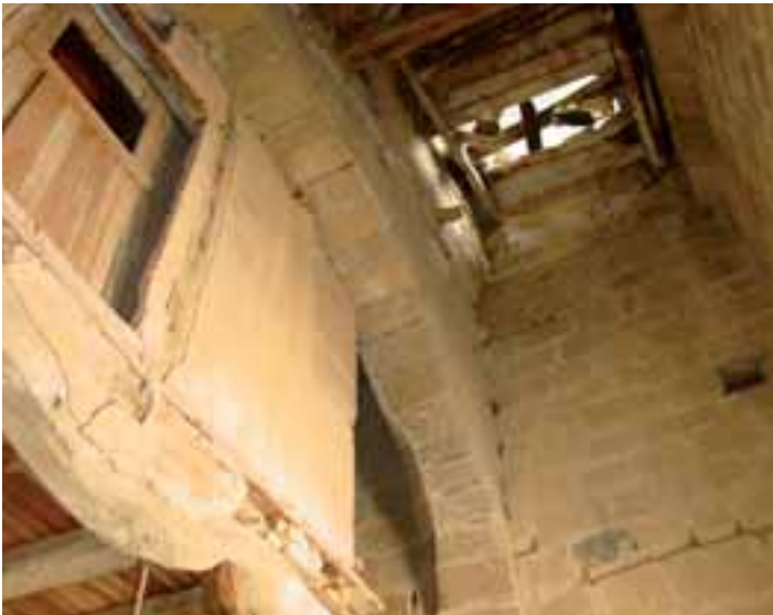
Interior de la torre de los Picos antes de la rehabilitación. Cuarto del reloj
