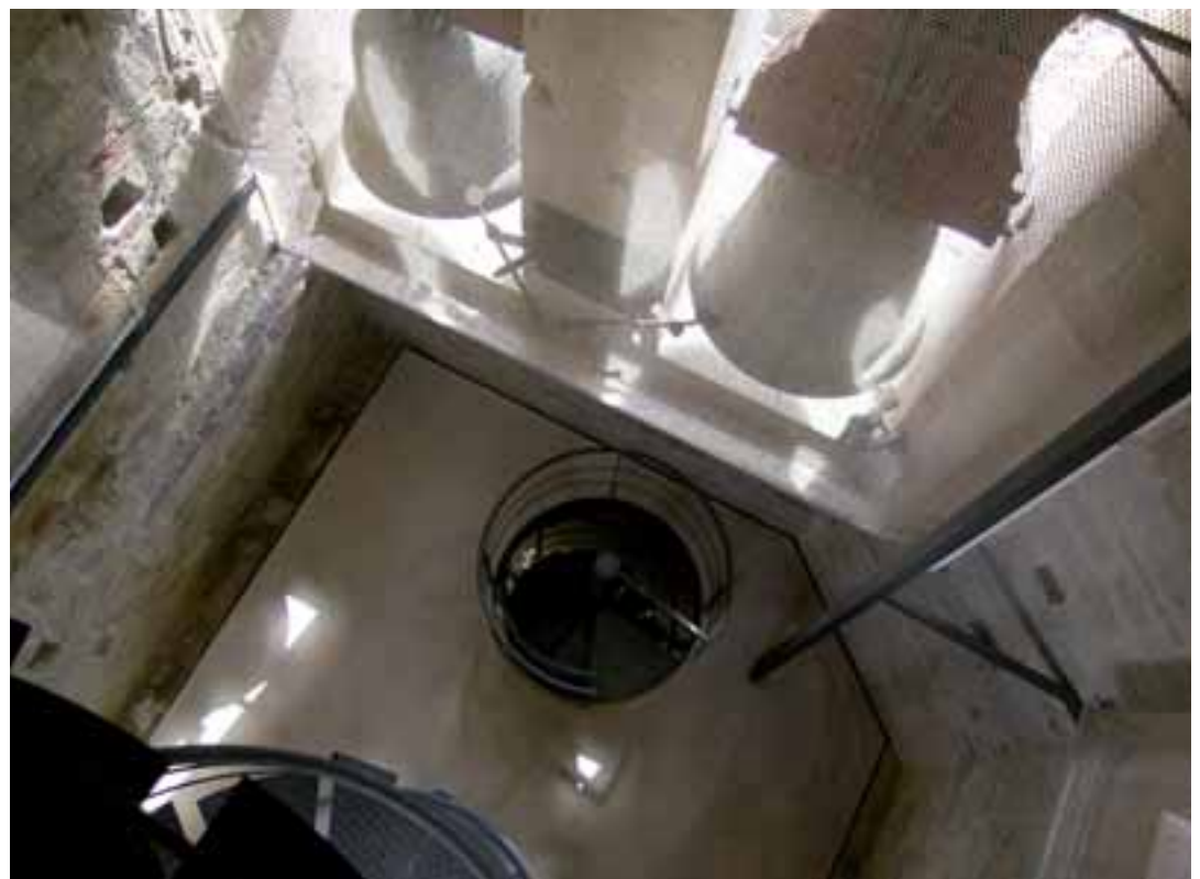
Mallas textiles en el piso de campanas
