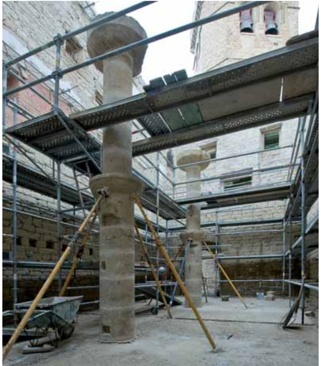
Montaje de los pilares de la primera planta de la casa parroquial
