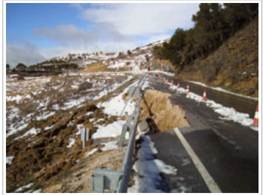
Imagen de la carretera NA-5310 afectada por el desprendimiento.
