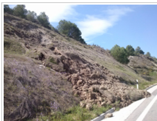
Deslizamiento de talud en la variante de Funes.
