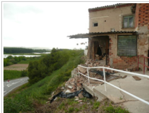
Desprendimiento de talud en Sartaguda.
