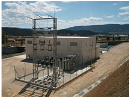
Vista exterior de la central hidroeléctrica de la toma del Canal de Navarra.
