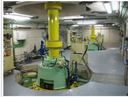
La sala de turbinas de la central hidroeléctrica de la toma del Canal de Navarra.
