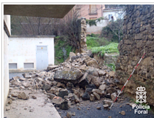
Imagen del muro derrumbado anoche en Sangüesa.
