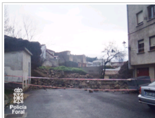
Otra imagen del muro derrumbado en Sangüesa.
