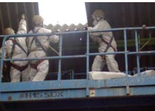
Figura A3.22 Desmontaje de piezas enteras para la retirada de una cubierta de fibrocemento
