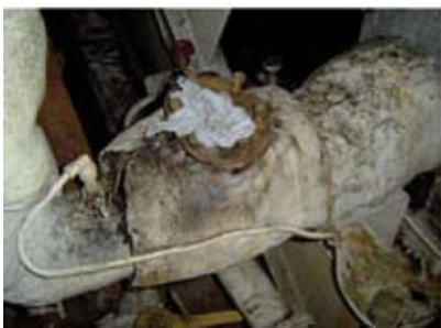
Figura A1.29 Detalle de calorifugado (textiles)
