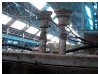
Figura A1.36 Aislamientos eléctricos en un horno
