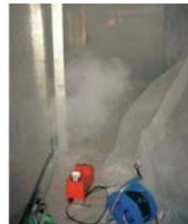
Figura A3.9 Control de la eficacia del confinamiento mediante una prueba de humo
