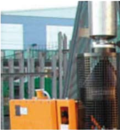
Figura 41. Caja ignífuga de sistema de combustible.
