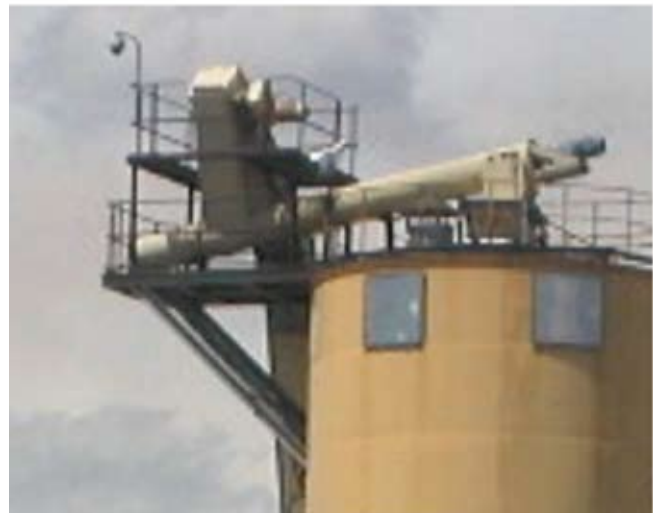
Figura 37. Los sistemas de descarga de la explosión deben instalarse de manera que la descarga se produzca a lugar seguro sin afectar a otros equipos ni a los trabajadores.
