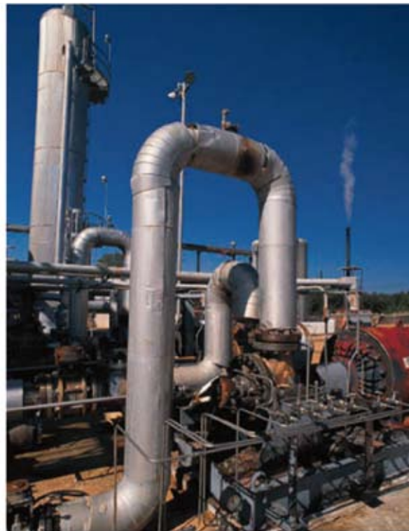
Figura 23. Fallos en bridas, válvulas y elementos de unión.
