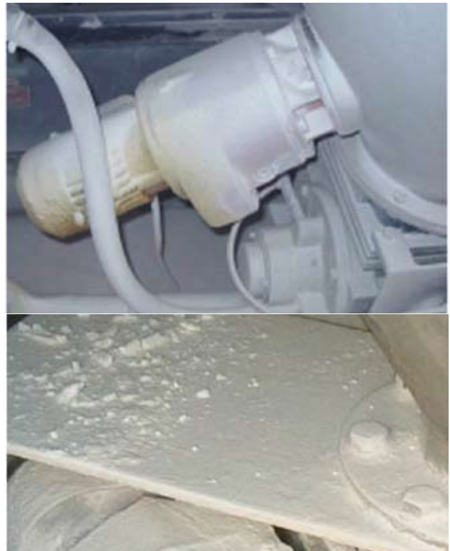
Figura 17. La acumulación de polvo debe ser evitada. Un procedimiento de limpieza adecuado puede evitar la clasificación de la zona.
