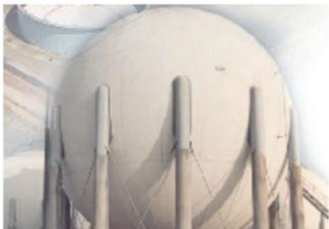
Figura 1. Por ejemplo: el gas natural licuado se almacena a presión atmosférica y temperatura -161^{\circ}\text{C} . En su interior no hay aire, luego no es de aplicación el RD 681/2003.
