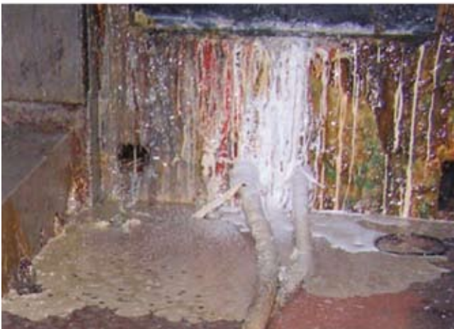
Figura 16. Los derrames y acumulación de sustancia inflamables deben ser eliminados inmediatamente con procedimientos adecuados para evitar su filtración.
