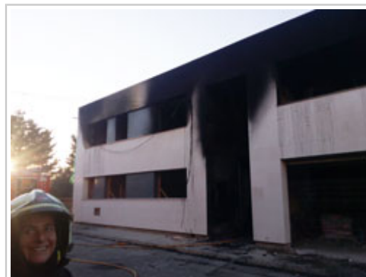
El fuego causó graves daños en la casa de Murchante.
