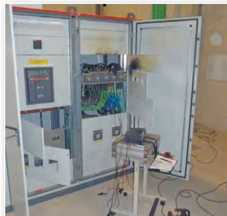
Armario eléctrico en el que se produjo el accidente.
