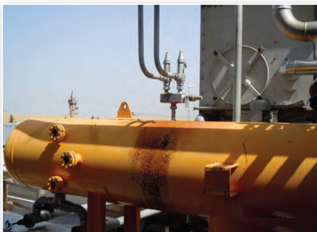
Depósito de amoníaco con indicación de la válvula que se rompió.
