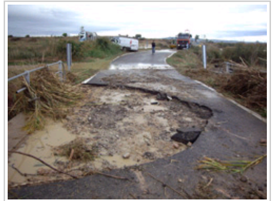
Vista de los daños ocasionados por las lluvias en la NA-5390, pk 5.
