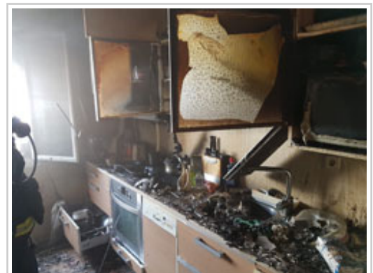
El fuego ha afectado a la cocina.
