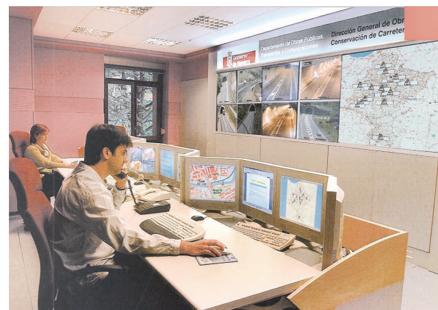
Centro de Control de Carreteras.
