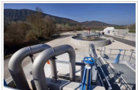
Instalaciones de la depuradora de aguas del Valle de Lónguida.
